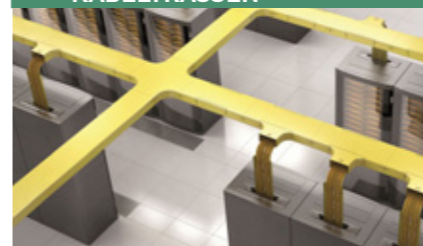
14. GLASFASERKANÄLE UND KABELTRASSEN
