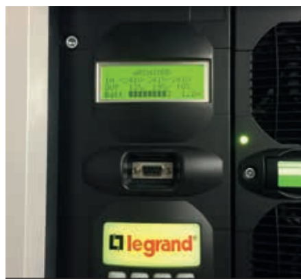
Dank Minkels Archimod USV, den reihenbasierten VariCondition®DX-Kühlern und einem cold aisle enclosure nach Mass wird Platz gespart.
